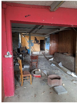
Annexe 3c: Dégâts
