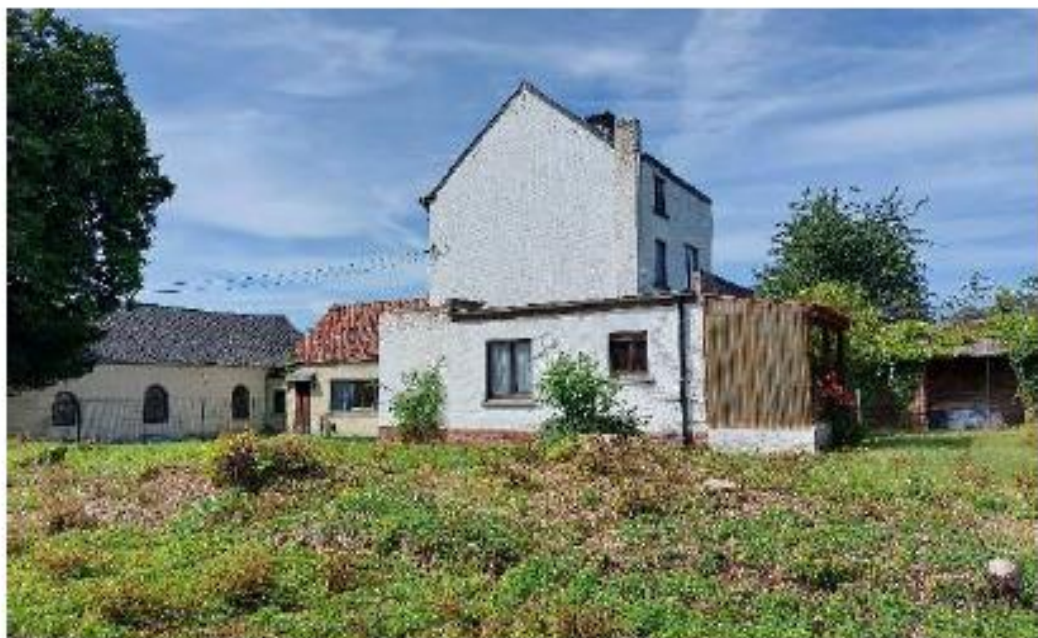
Maison située sur la parcelle A602b2 destinée à la démolition (derrière église)
