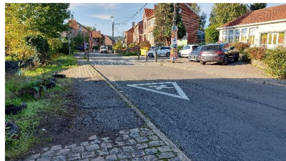
Trottoir en mauvais état à Tangissart (ICEDD 2022)
