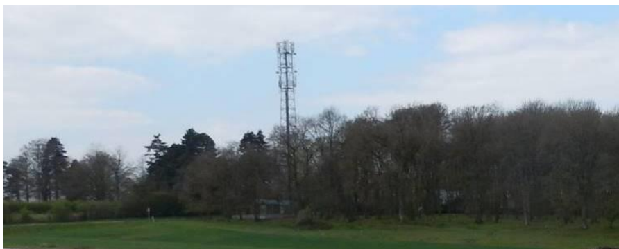
Figure 141: Vu d'une antenne téléphonique de la Rue de Noirhat (AGORA avril 2019)
