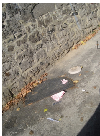
III.1.1.5.3.2 Figure 33 : Dépôt d'immondices à proximité de l'église de Brugelette (JNC AWP)
